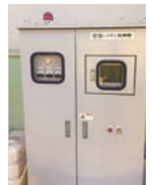
灯油使用量の削減に大きく貢献している「エコキュート」(東京工場)
