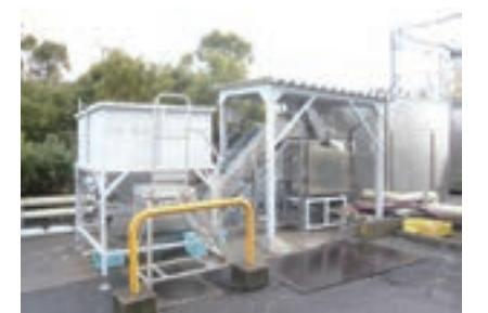
生ゴミ排出量の削減に大きく貢献している生ゴミ処理機(東京工場)
