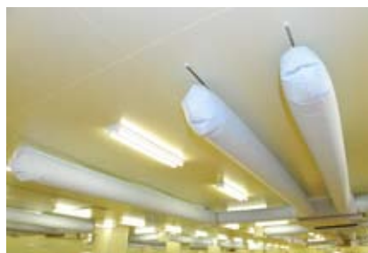
(株)京樽船橋工場ではエアコンの吹き出し口にカバーをかけ、送風のムラを防いでいる
