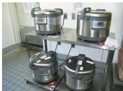
オール電化厨房では、炊飯器4台が稼働
